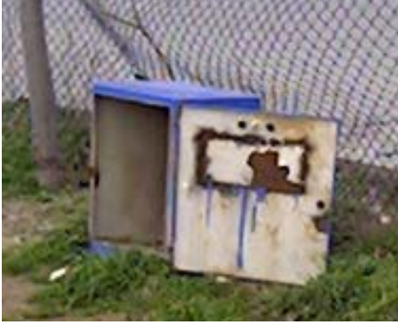
Tahrip olmuş elektrik panosu
