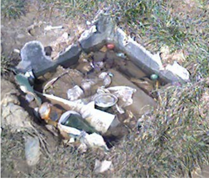
Tahrip edilmiş sulama tesisat vanası
