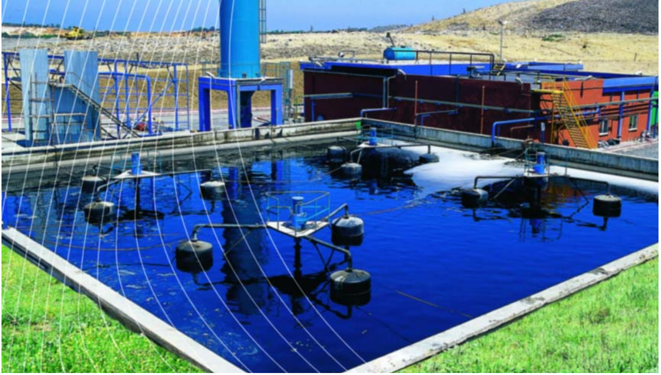
Çöp Suyu Arıtma Tesisi
