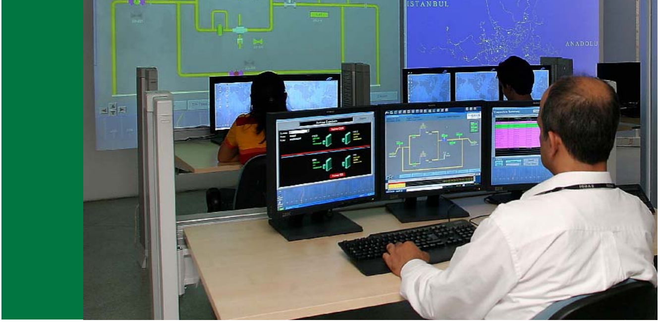
SCADA Merkezi Kontrol ve Veri Toplama Sistemi.
