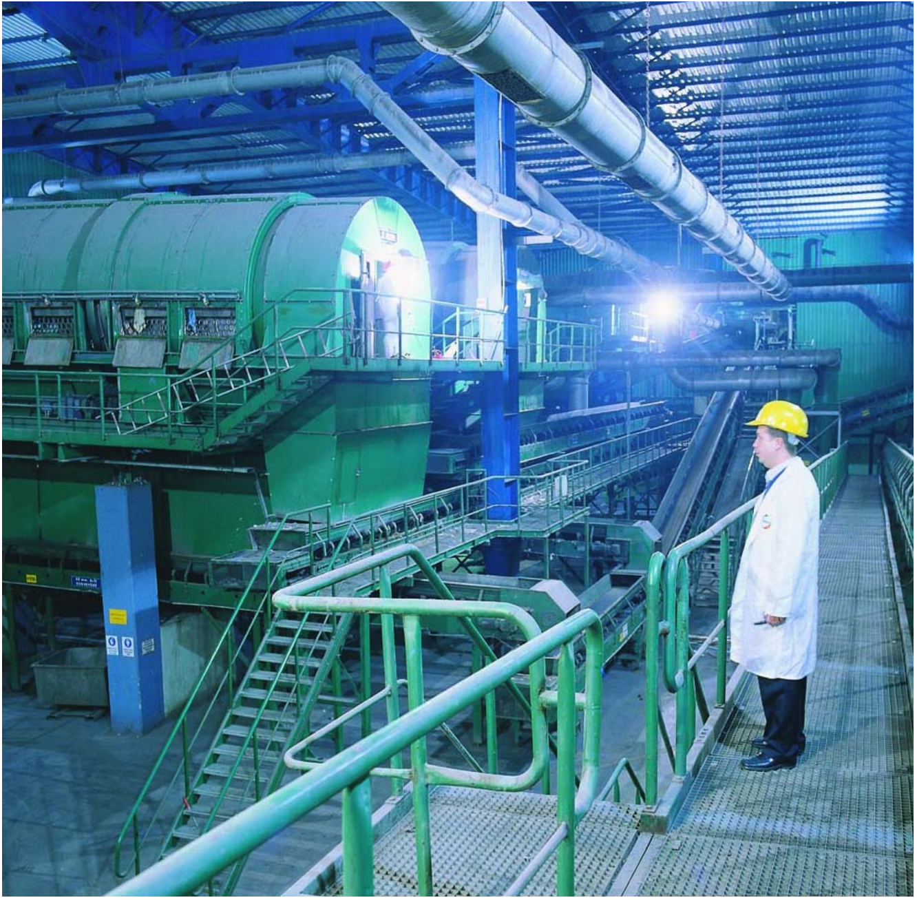
Kompost ve Geri Kazanım Tesisi
