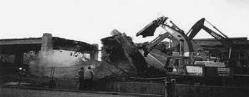
San Francisco'da depremde çöken çevreyolu yıkıldı ve ortadan kaldırıldı
