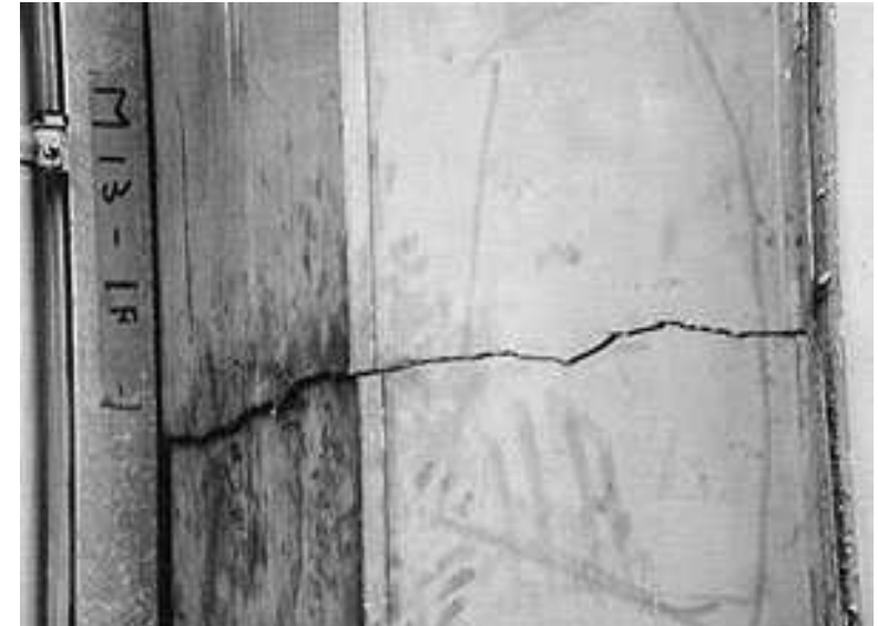
Ashiya, Hama sahil kasabasında bir süper gökdelenin çelik sütununda meydana gelen yatay çatlak
