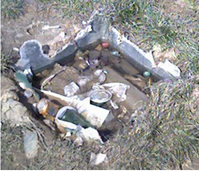
Tahrip edilmiş sulama tesisat vanası
