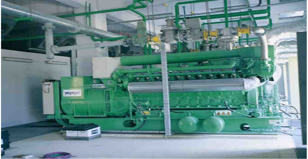
Depo Gazından Elektrik Üreten Özel Gaz Motoru
